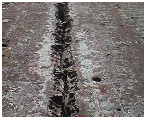
Fig. 8. Deep longitudinal cracks
