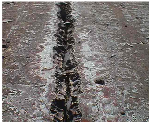
Fig. 8. Deep longitudinal cracks
