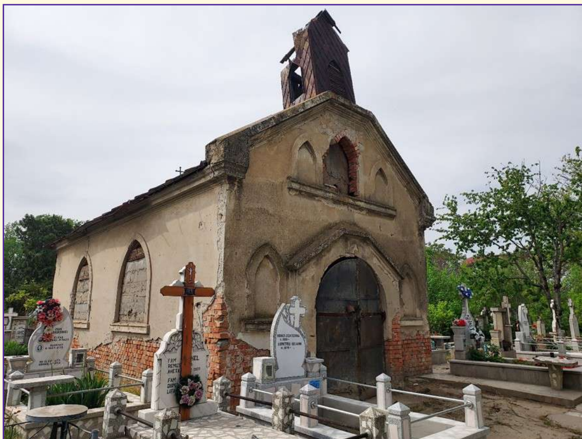
Capela Anglicană din Cimitirul Eternitatea, în stadiu avansat de degradare
